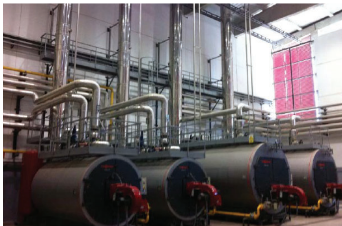
Figura 1: Detalle de la sala técnica térmica de la caldera, diseñada para las correctas funciones de mantenimiento. Fuente: elaboración propia.
