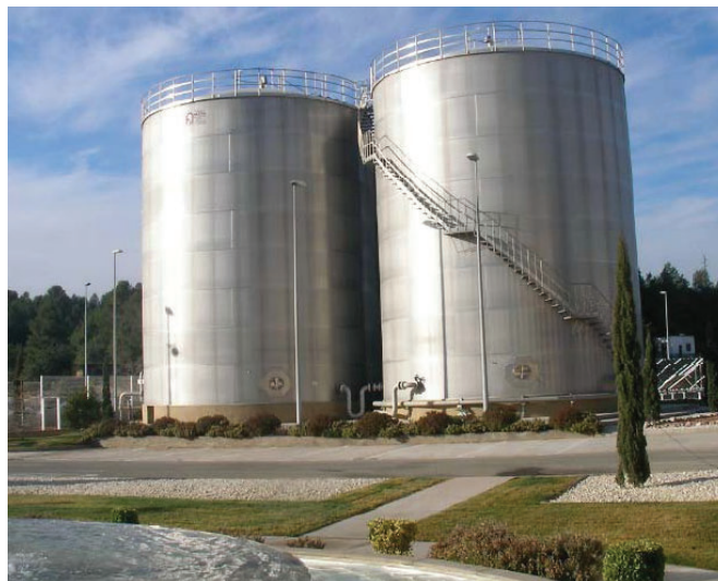
Figura 7: Detalle de los tanques de almacenamiento de agua de lluvia. Fuente: elaboración propia.
