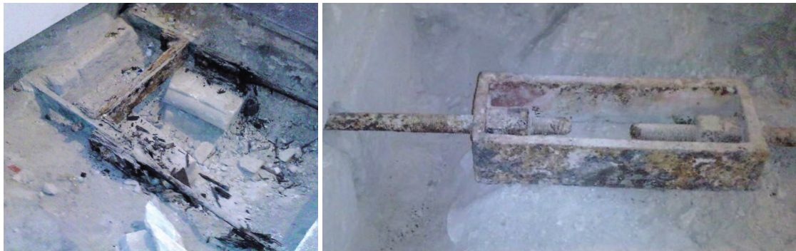
Imagen 6. Estado inicial del sistema de atirantado. Image 6. Initial state of the cable-stayed system
