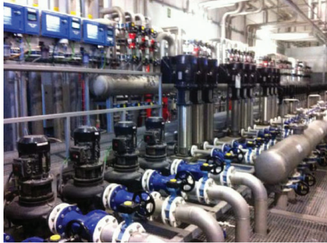
Figura 4: Detalle de salas de fluidos, con sistemas de regulación mediante accionamientos electrónicos. Fuente: elaboración propia. Figure 4: Detail of fluid rooms, with regulation systems using electronic drives. Source: own elaboration.
