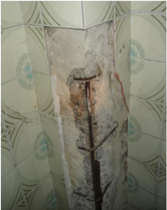
Imagen 1. Daños por corrosión Image 1. Corrosion damage
