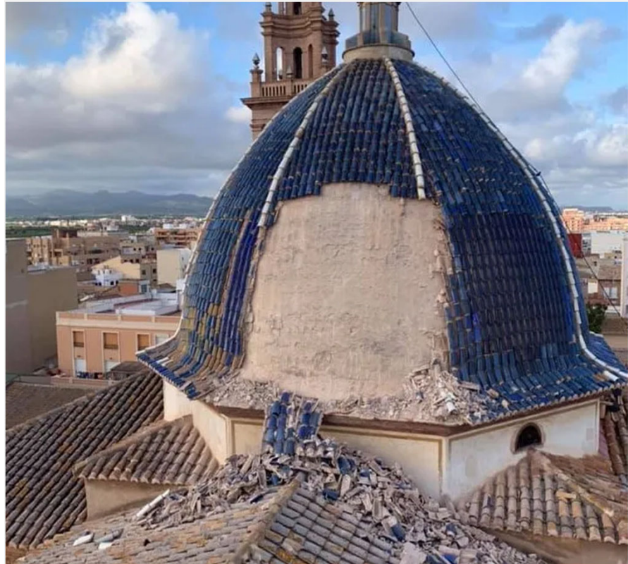
1. Fotografía detalle del derrumbe de las tejas del sector sur. Foto tomada mediante dron el día 19/10/20 (Luis Cortés Meseguer, José Pardo Conejero 2023) 1. Detail photograph of the collapse of the tiles in the southern sector. Photo taken by drone on 10/19/20
